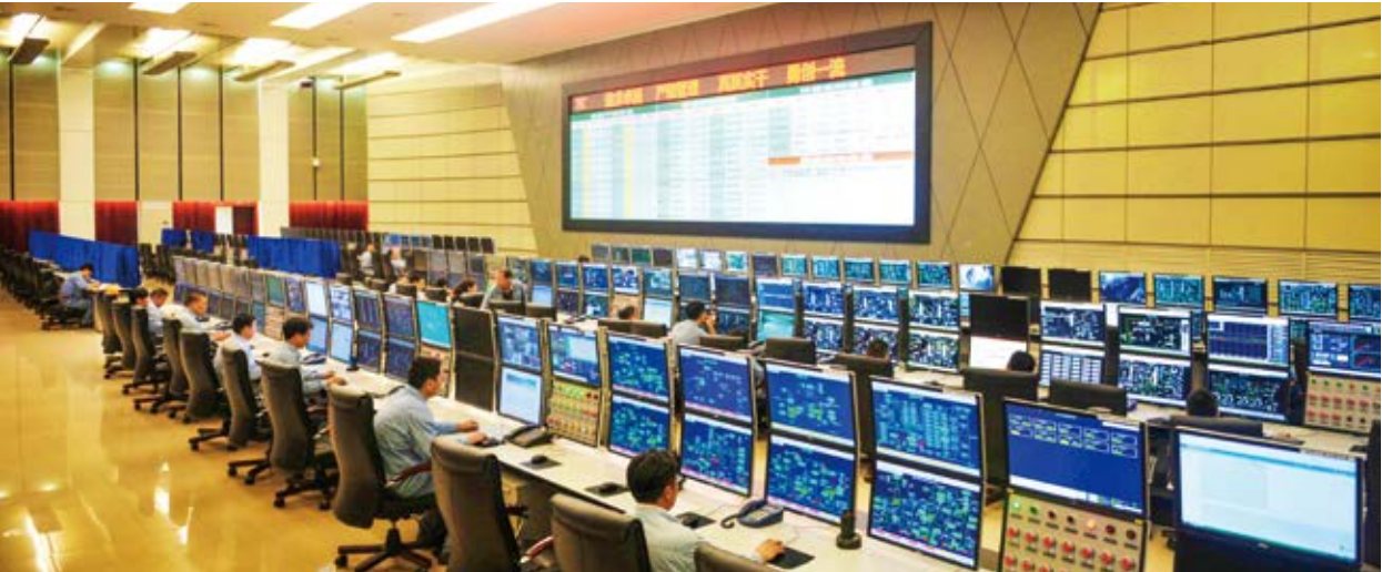
▲ 中国石化九江石化公司生产管控中心中央大厅
